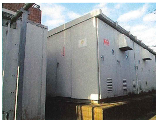
維孝館中学校高压受電設備
