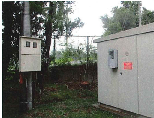
宇治田原小学校高压受電設備
