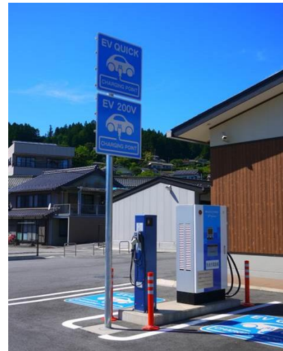
電気自動車用の充電設備
