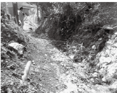
高尾の阿弥陀寺下の素掘りの側溝。スムーズに雨水が流れるようコンクリート製の側溝を設置します。
