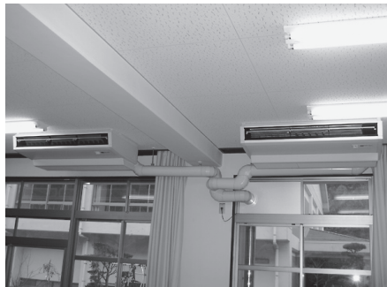
▲設置された空調設備
