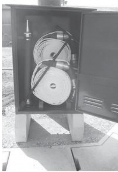
消火栓ボックス内の器具
