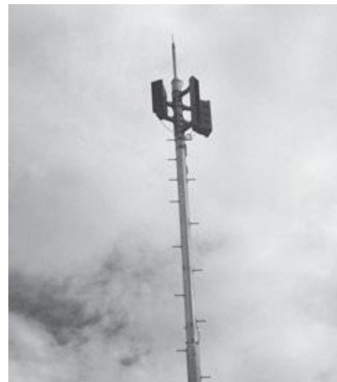
各地区に設置されている防災スピーカー
