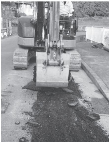
下水道面設備
