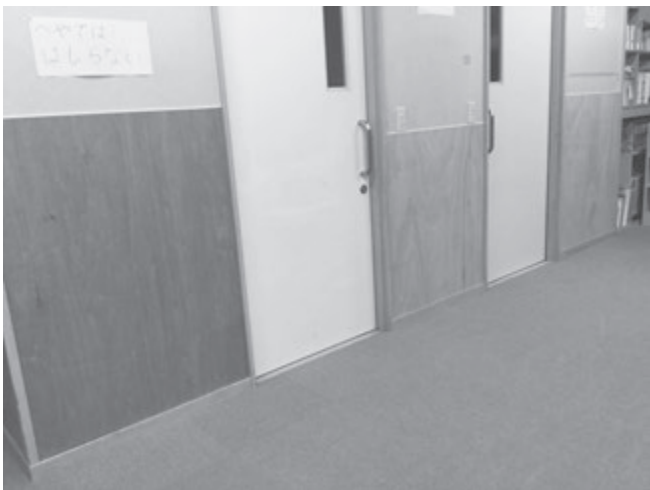
修理された施設壁面だが…
