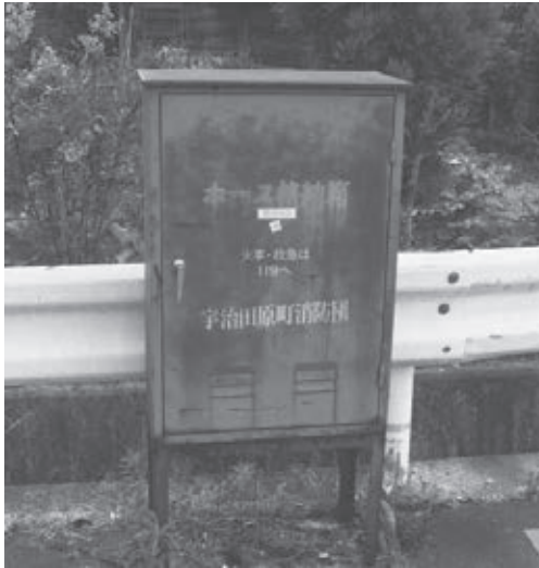
ホース格納庫
