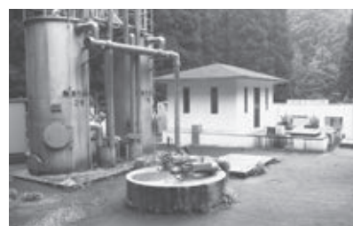
奥山田浄水施設
