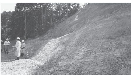
崩落箇所(郷之口湯屋谷線)
