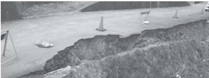
符作川の護岸崩落箇所
