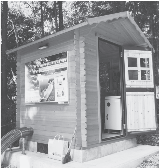
小水力発電施設 (荒木)
