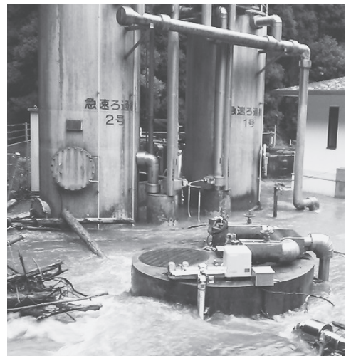
奥山田簡易水道施設も被災
