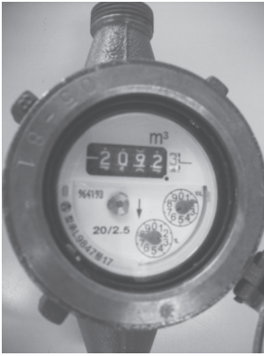
水道メーター
