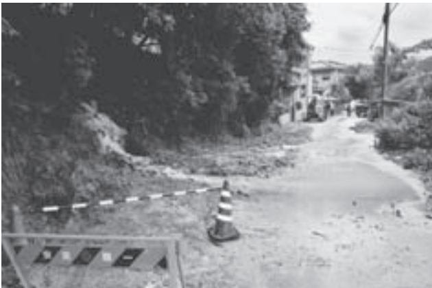
土砂崩れが起きた町道
