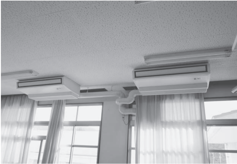
空調設備 (宇治田原小学校)
