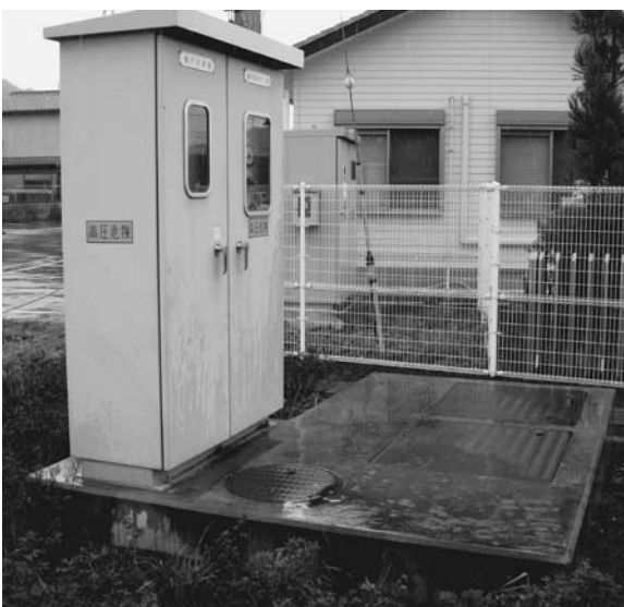
取水が停止された船戸取水井
