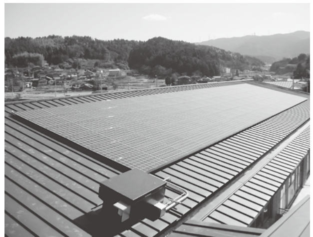
太陽光パネル（維孝館中学校）
