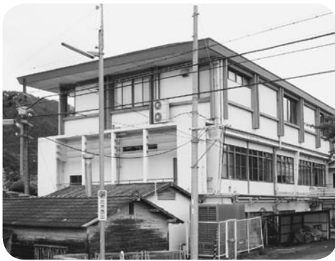
耐震対策が必要な役場庁舎
