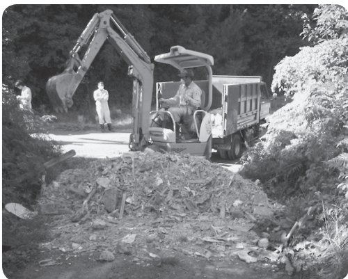
12 t もの建築廃材が不法投棄された現場
