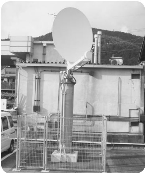
衛星通信系防災無線アンテナ（役場）
