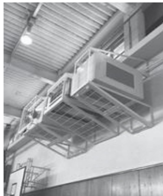
他市の体育館に設置された空調設備
